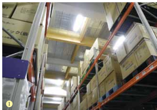
①電動移動ラックは必要な間口のみ開閉，その通路だけ天井の蛍光灯が自動的にオンオフする
